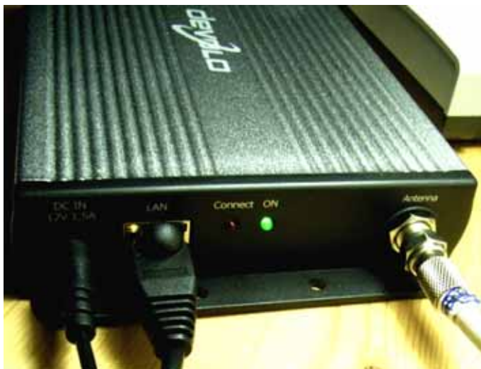
Rückseite des Satellitenreceivers: Links der Stromanschluss, daneben das LAN-Kabel und rechts der Anschluss an die Satellitenantenne. Die rote LED leuchtet, wenn Daten übertragen werden. Foto: Hurcks
